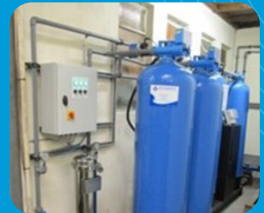
Rinse Water Recovery DI Systems
